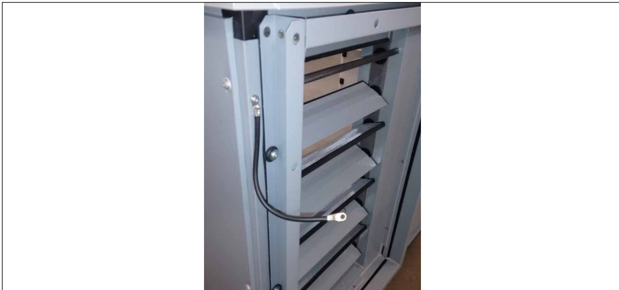
Afb. 16 Aan apparaatzijde aangebrachte potentiaalvereffening
