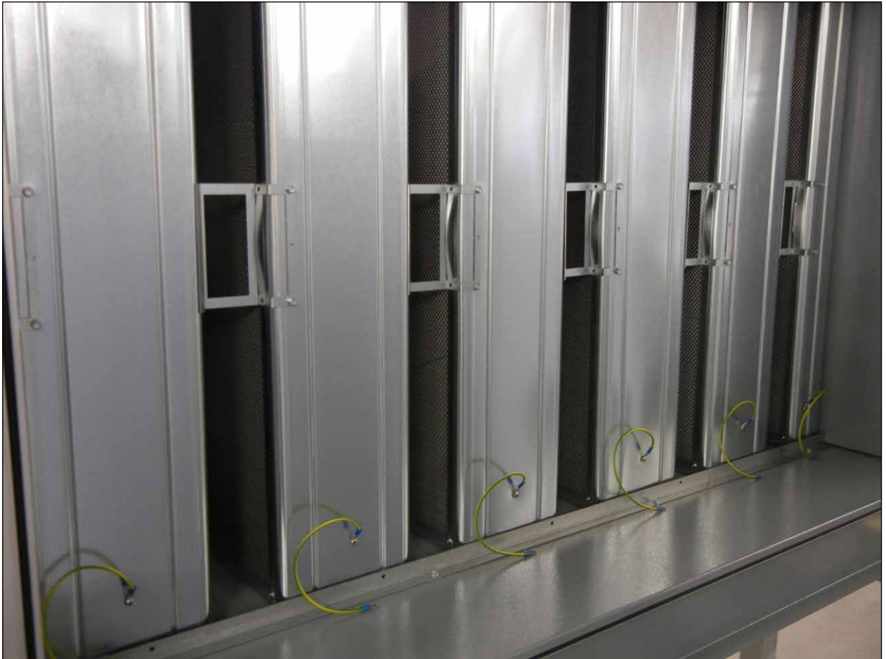
Afb. 66 Meerdere geluidsisolatiecoulissen met potentiaalvereffening
