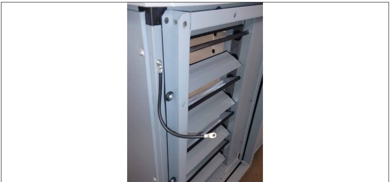
Afb. 6 Aan apparaatzijde aangebrachte potentiaalvereffening
